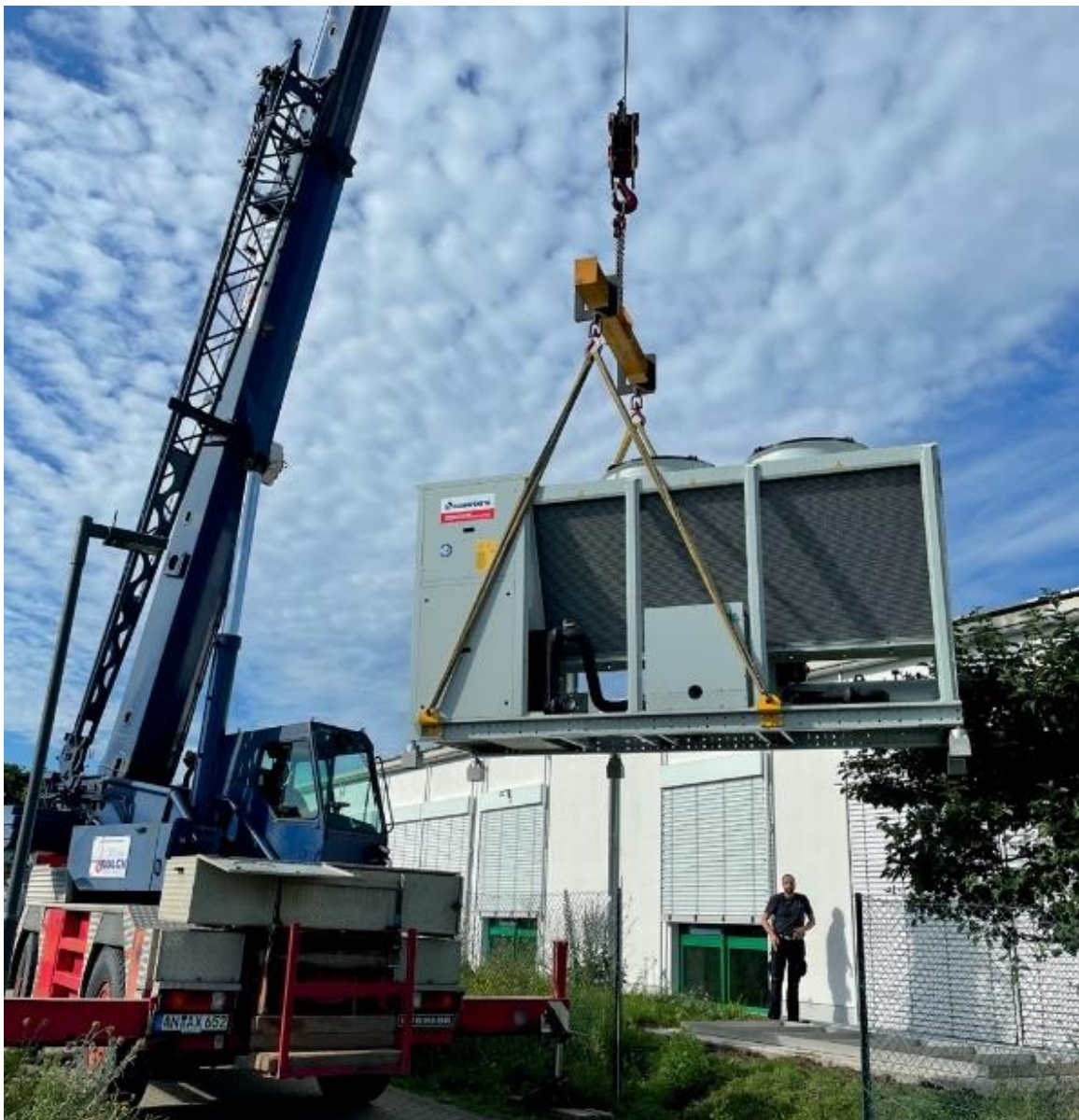
Abbildung 1: Lieferung einer neuen hocheffizienten Klimaanlage für die Fertigung zur Reduktion von CO 2 -Emissionen
